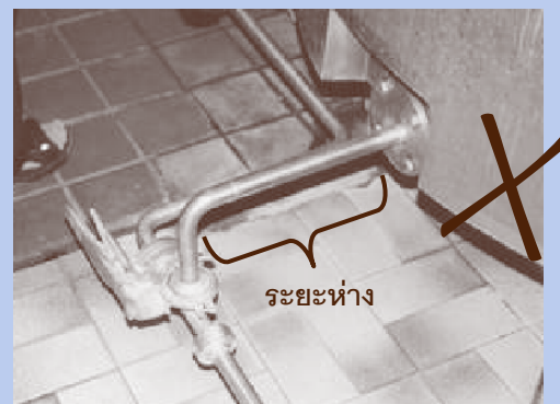
ภาพที่ 49 : การติดตั้งวาล์วห่างจากถัง
