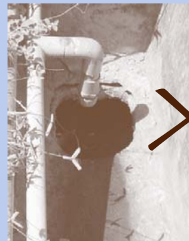
ภาพที่ 6 : ทางระบายน้ำนออกอาคารไม่มีตะแกรงดักเศษอาหารเพื่อป้องกันการอุดตัน
