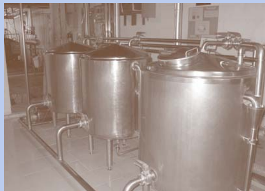
ภาพที่ 25 : ห้อง/บริเวณการล้างระบบปิด หรือ CIP
